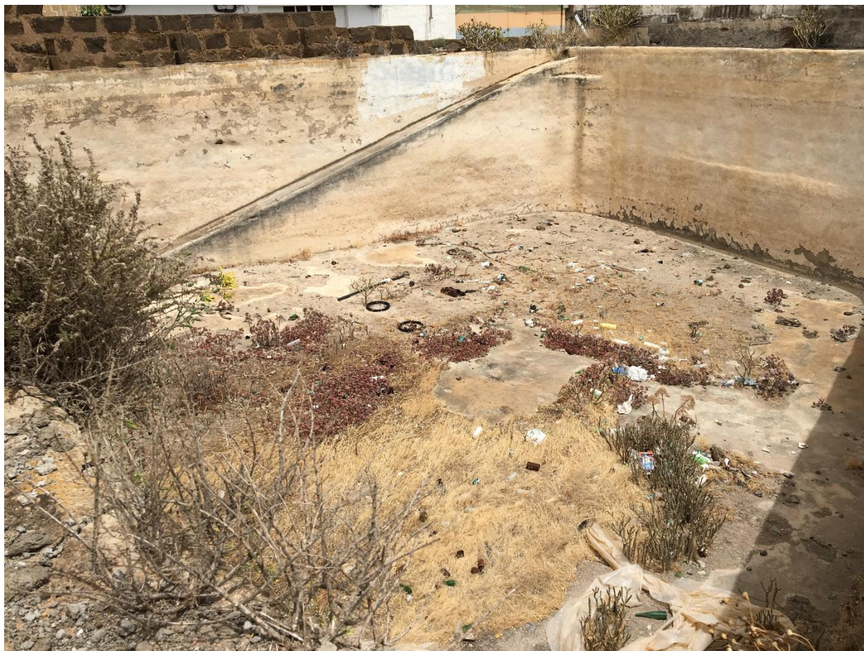
Infraestructura hidráulica presente en la parcela objeto de estudio. Fuente: Elaboración propia.
