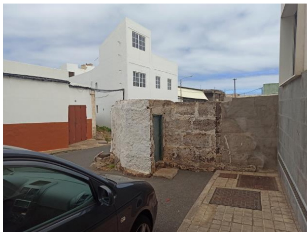
Muro del estanque en su extremo sur, fuera de alineación.
