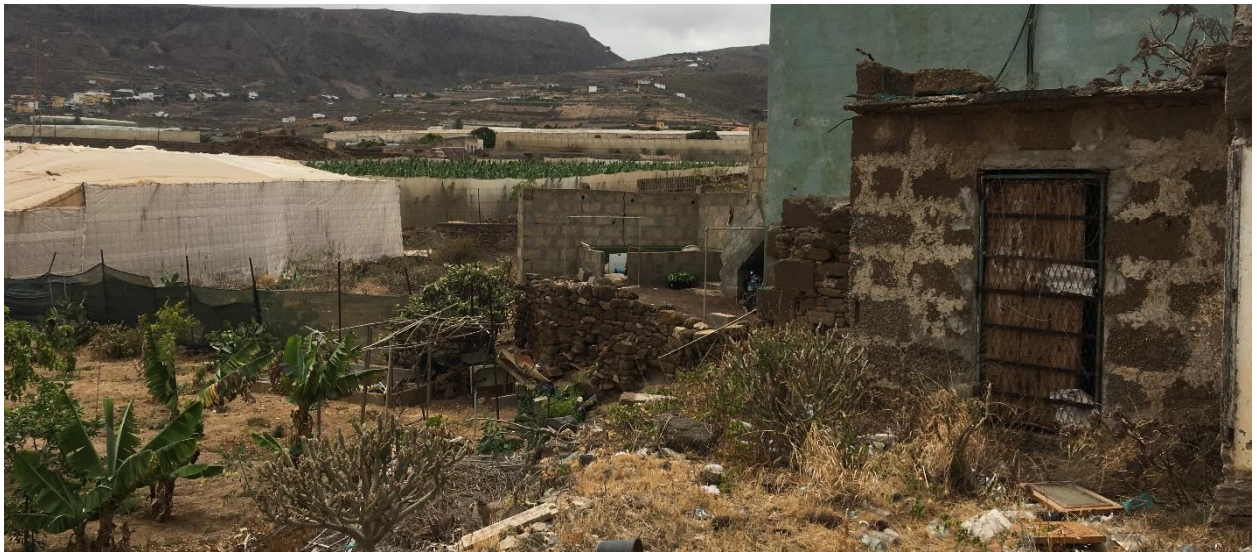
Figura 23 Ejemplo de mal estado de conservación de las edificaciones presente en la parcela objeto de estudio. Fuente: Elaboración propia
