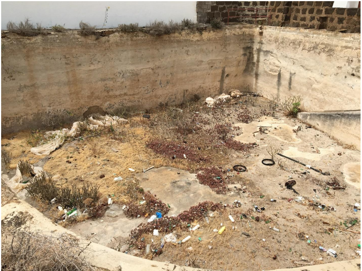
Figura 17 Infraestructura hidráulica abandonada con presencia de residuos sólidos urbanos presente en la parcela objeto de estudio. Fuente: Elaboración propia.
