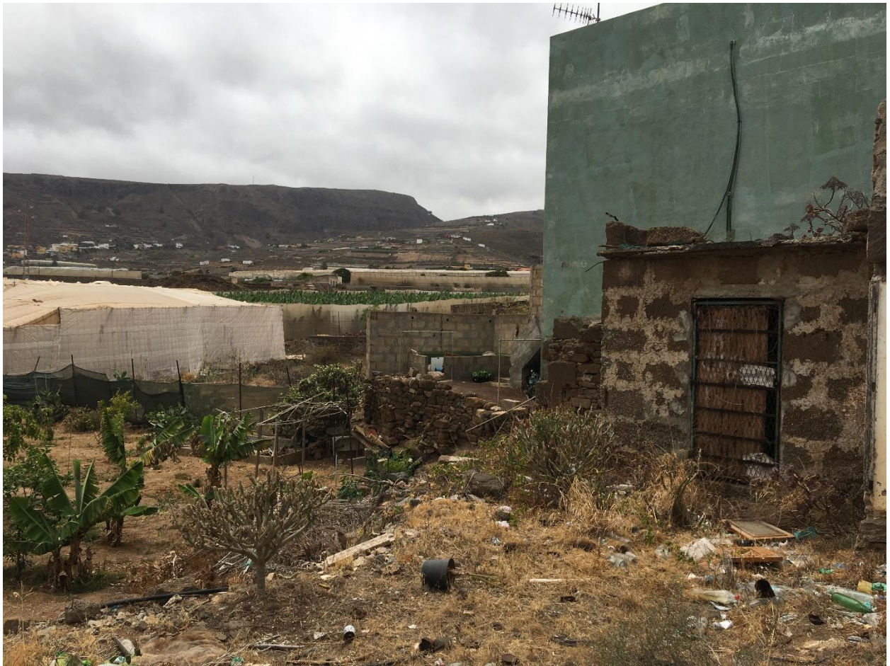
Figura 20 Edificaciones con riesgos de caída presente en el ámbito de estudio. Fuente: Elaboración propia, a partir de IdeCanarias e IdeGranCanaria.
